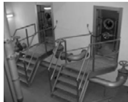
Rohrkeller mit Drucktüren
